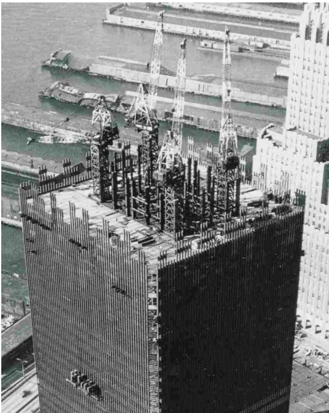
Een van de WTC-torens in aanbouw, in de jaren 1970. Duidelijk is de krachtige en rigide structuur te zien, waarom heen het gebouw werd opgetrokken. 7 á 8 cm-dikke stalen balken. De liften werden hiertussen in gesitueerd en zorgden voor de weerbaarheid van torens tegen o.a. vliegtuiginslagen.
